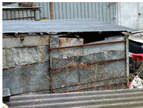
Construcții ilegale din curtea interioară a imobilului care servește drept sediu Casei de Cultură, cu acces din Bd. 16 Decembrie 1989
